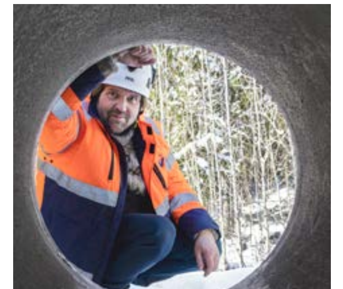
Kun suunnittelemme uusia saneeraustöitä, otamme yhteyttä työmaa-alueen taloyhtiöihin. Kiinteistön omistajat voivat samalla uusilla tonttijohdot, Tampereen Veden rakennuttajainsinööri Jukka Palonperä kertoo.
